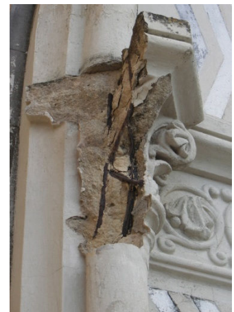
Distacco della porzione del capitello della finestra principale
