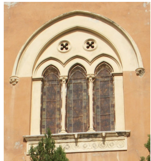
Trifora sul transetto ante operam
